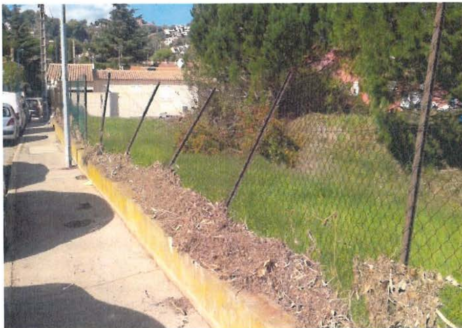
FIGURE 28 : PLOIEMENT DE CLÔTURES SOUS L'EFFET DE L'EAU – CRUE DU 03/10/2015
